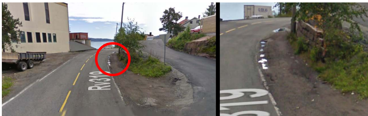
Figur 8 Ødelagt fortau som følge av smal vegbredde (Kilde: www.google.no/maps )
