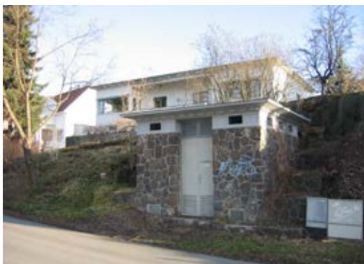
D2-42 Trafokiosk i Løkkebergveien 19A, tegnet av Bjarne Thinn Syvertsen for Drammens Elektrisitetsverk
