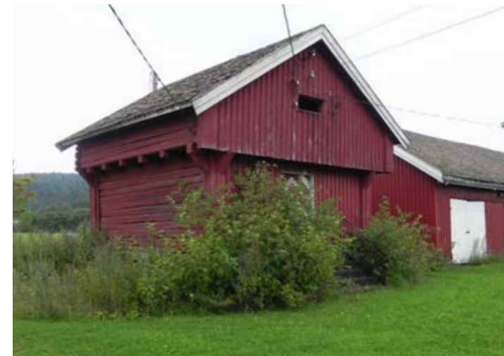
D1-13 Buret på Dæle prestegård, fra slutten av 1800-tallet, er en uvanlig type med stor utkraging på langsiden og inngangssiden.
