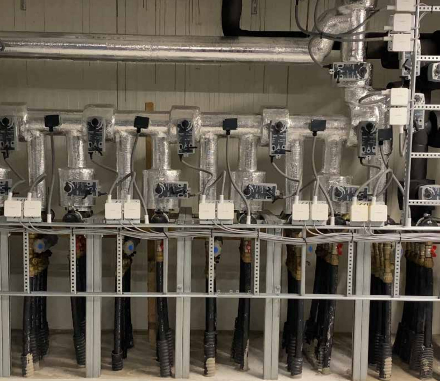
Disse rørene sender varme ned i fjellet.
