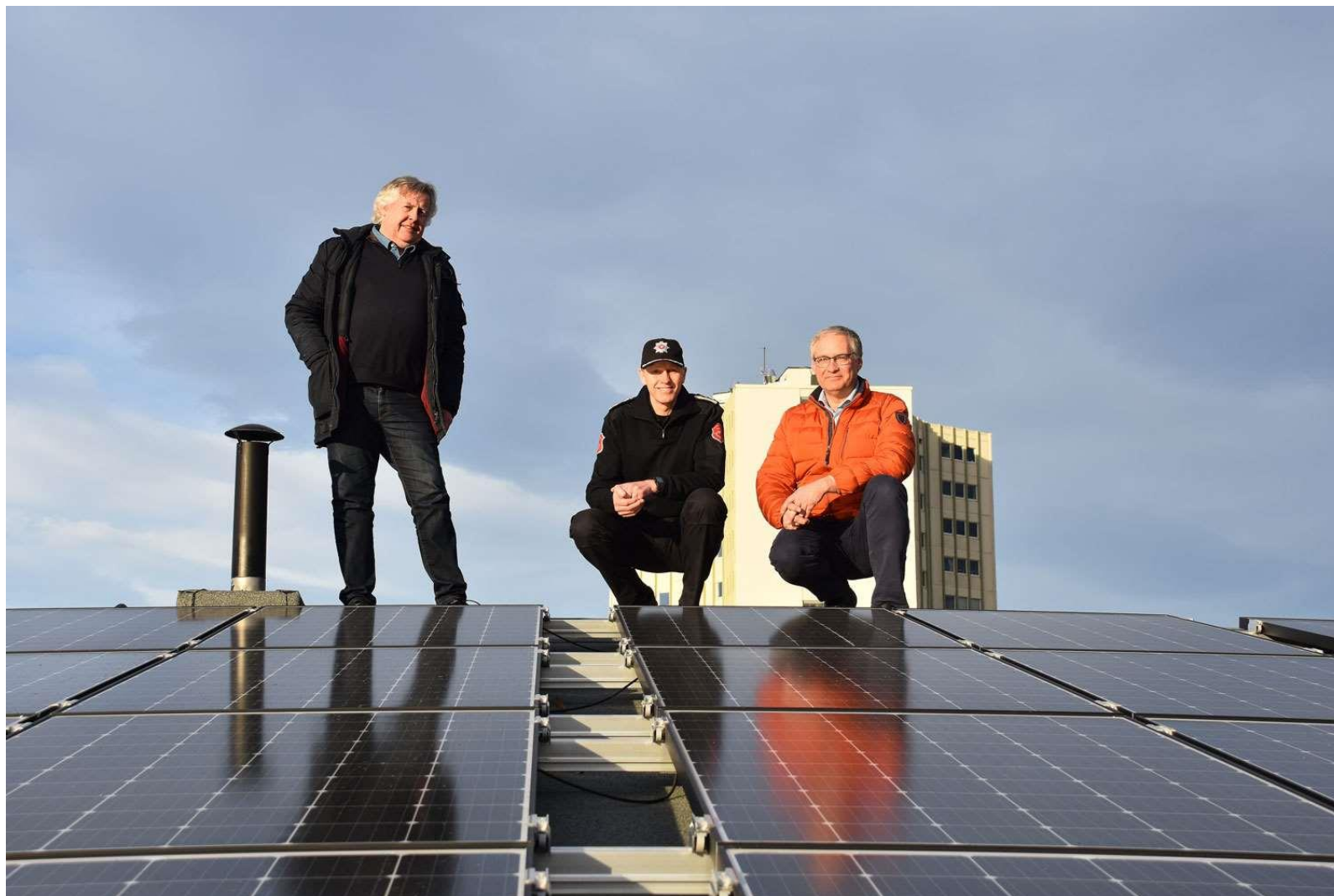
Solceller på Drammen Brannstasjon
